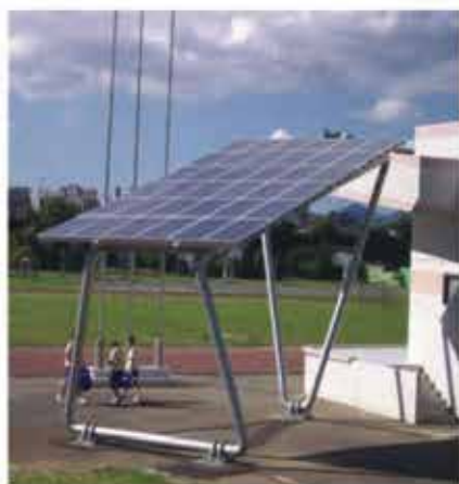
板橋國中太陽光電結構
