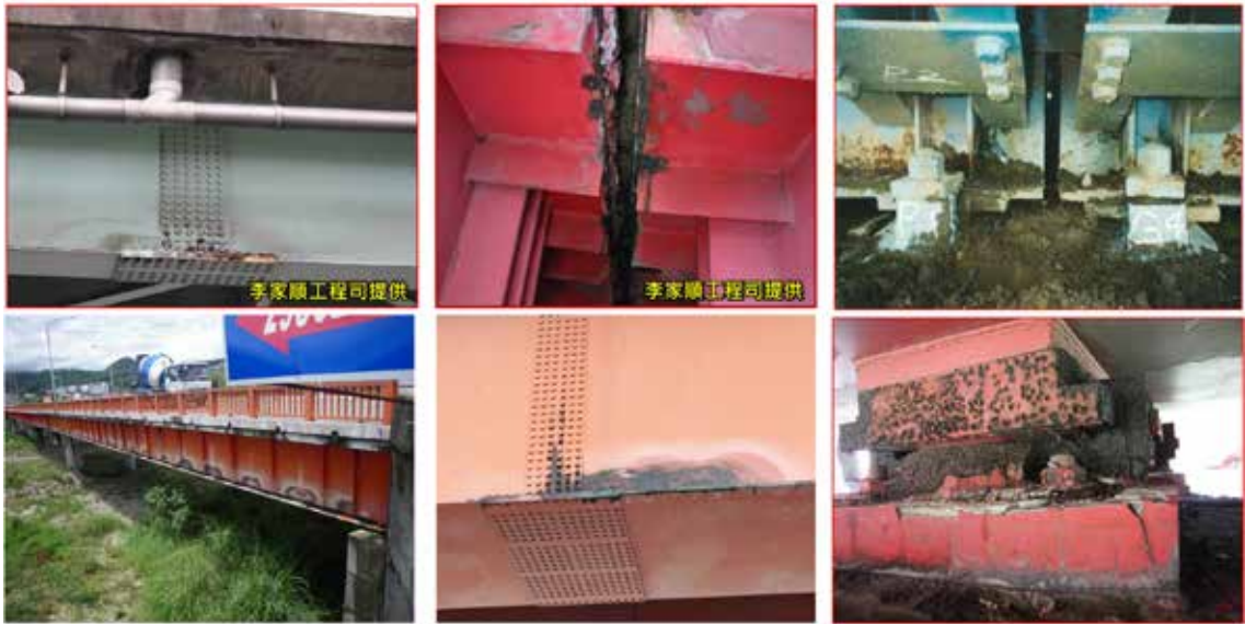
圖 9 鋼構橋梁經常發生之銹蝕
