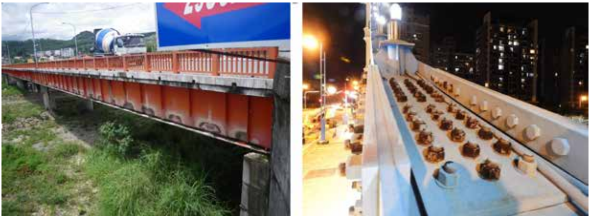
鋼構橋梁常見因設計或施工欠妥造成之銹蝕
