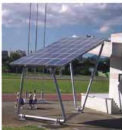
板橋國中太陽光電結構
