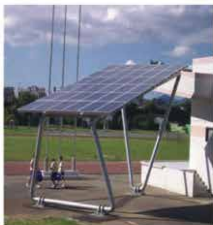
板橋國中太陽光電結構
